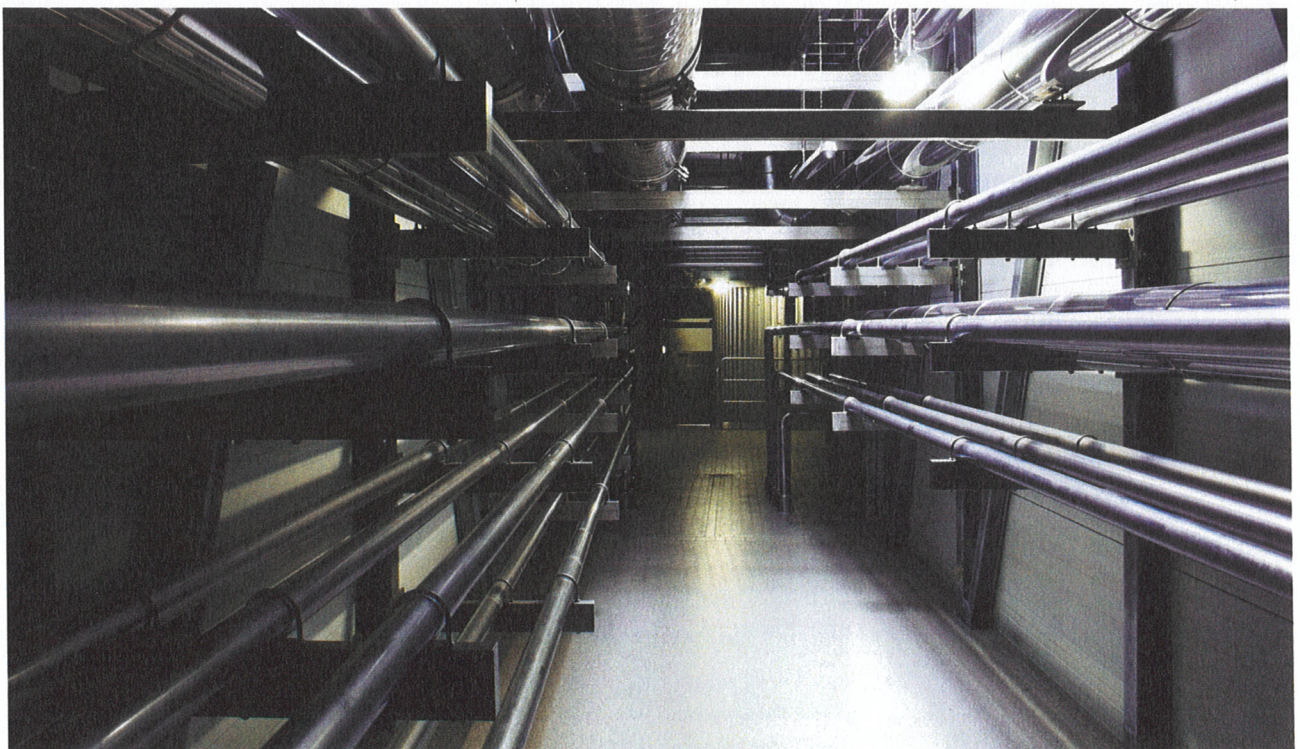
Bild 3. Neben der Auslegung und Installation des Kraftwerks gehörten auch der Anschluss der Kälteerzeugung und CIP-Anlagen an die Energiezentrale zu den Aufgaben der Ingenieure aus Abensberg
