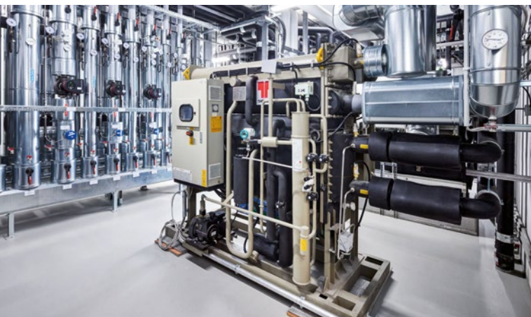
Da vor allem im Sommer ein hoher Kältebedarf besteht, wurde eine Absorptionskältemaschine installiert.
