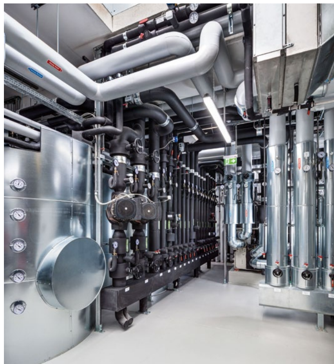
Die Kältezentrale verfügt über mehrere Pufferspeicher, sodass der Energieverbrauch für die benötigten Temperaturen sehr niedrig gehalten werden kann.
