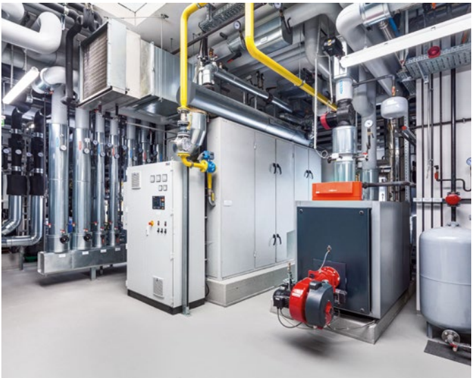
Ein Blockheizkraftwerk arbeitet nach dem Prinzip der Kraft-Wärme-Kopplung und stellt die benötigte Energie für verschiedene Prozesse im Unternehmen bereit.
