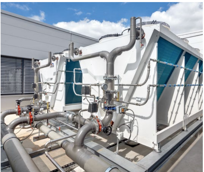
Rückkühler für die Kälteanlage. Die Kälteanlage erzeugt sowohl im Sommer als auch im Winter ausreichend Kälte für den Betrieb.
