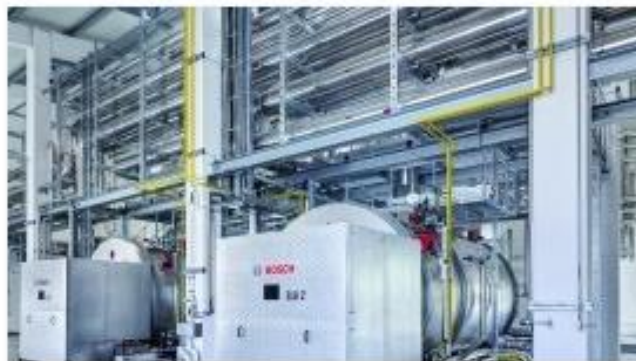
Abb. 2: Für die erste Ausbaustufe wurden zwei Spitzenlastdampfkessel mit je 10 t/h Dampf und 10 bar installiert, sodass eine abgesicherte Leistung von 15 t/h garantiert werden kann. In der zweiten Ausbaustufe soll ein dritter Spitzenlastdampfkessel für bi
