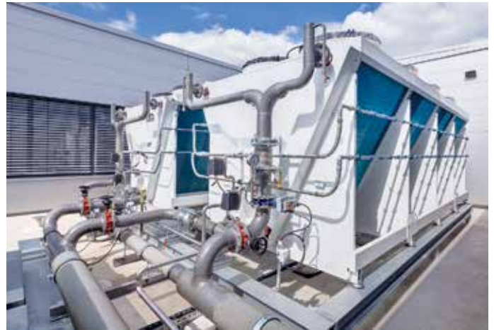
Die Kälteanlage erzeugt sowohl im Sommer als auch im Winter ausreichend Kälte für den Betrieb.
