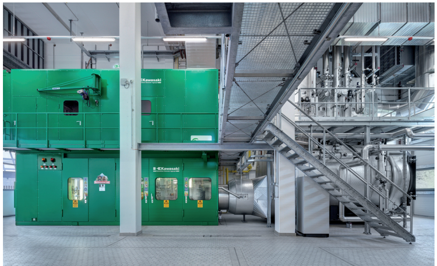
Um einen Großteil des hohen Jahresdampfbedarfs selbst zu decken, wurden eine Gasturbine, ein Abhitzedampfkessel sowie zwei Spitzenlastkessel installiert.
