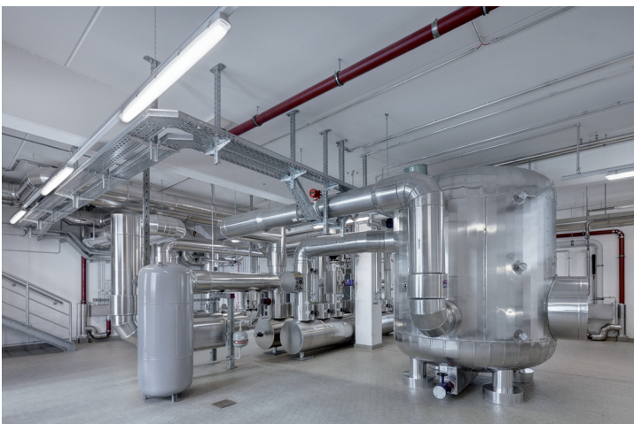
Mit der neuen Energiezentrale ist der Einstieg auf die Heizwasserversorgung am Standort erfolgt.
