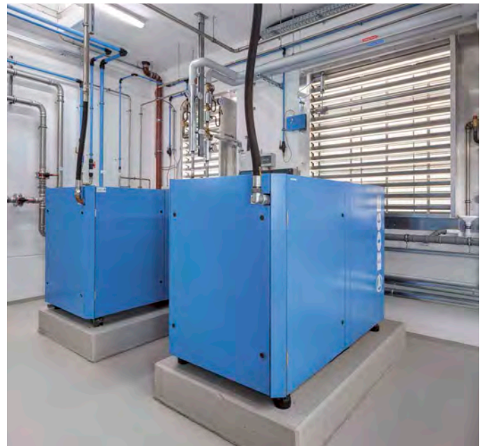
10 In der Druckluftzentrale wird die Abwärme der Kompressoren optimal zur Klimatisierung des neuen Produktions- und Verwaltungsgebäudes genutzt.
