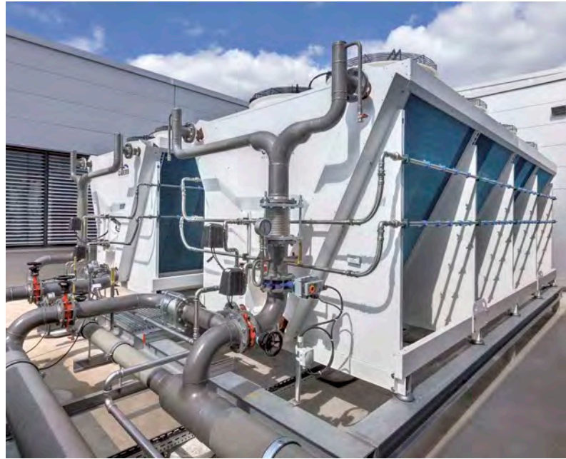
7 Die Kälteanlage erzeugt sowohl im Sommer als auch im Winter ausreichend Kälte für den Betrieb.
