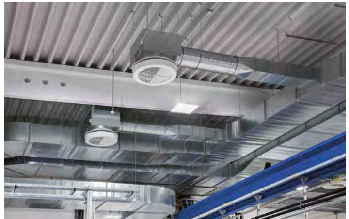
3 Mit der Installation einer zentralen Energieversorgung erfolgte auch die Einführung eines ganzheitlichen Kühl- und Klimatisierungskonzepts für das neue Produktions- und Verwaltungsgebäude.
