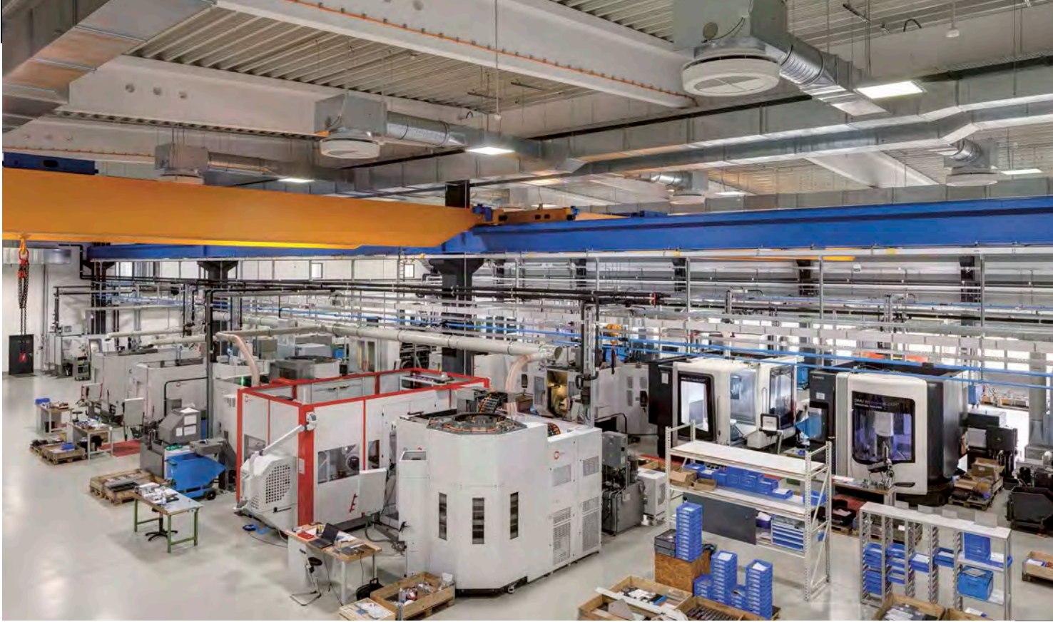
2 Da Temperaturschwankungen einen starken Einfluss auf die Qualität der Produkte haben, beauftragte das Unternehmen ein Ingenieurbüro unter anderem damit, eine zentrale Kühlanlage für das neue Produktions- und Verwaltungsgebäude zu planen und zu installieren.
