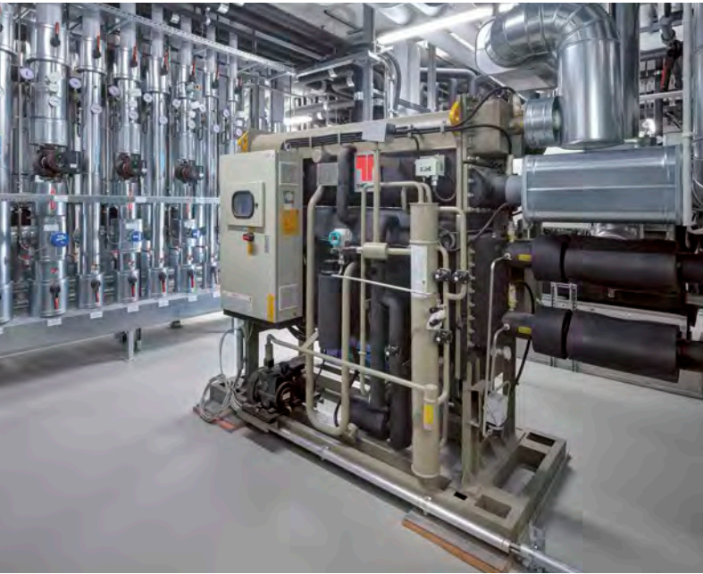
8 Um den Betrieb mit der erforderlichen Kälte zu versorgen, wurde eine Absorptionskältemaschine installiert.
