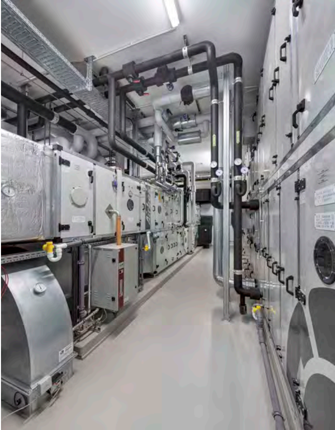
5 Die Steuerung der Raumlufttechnik erfolgt über die Luftzentrale. Da sowohl die Maschinenkühlung als auch die Hallenkühlung zentral erfolgt, kann das Blockheizkraftwerk, das Strom, Wärme und Kälte bereitstellt, sowohl im Sommer als auch im Winter effizient ausgenutzt werden.
